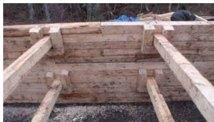
Figure 31. Structures en U pour stabiliser les travers.
