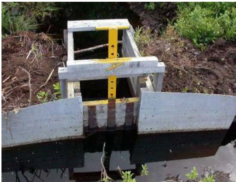
6a. Contrôle de niveau d'eau (barrage)
